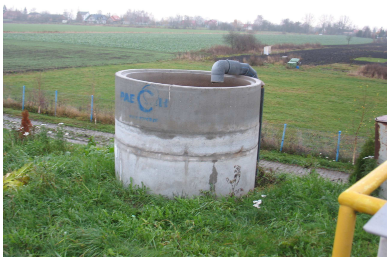
Wlot ścieków (źródło: archiwum własne)
