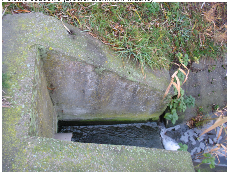
Wyłot ścieków oczyszczonych do kanału (źródło: archiwum własne)
